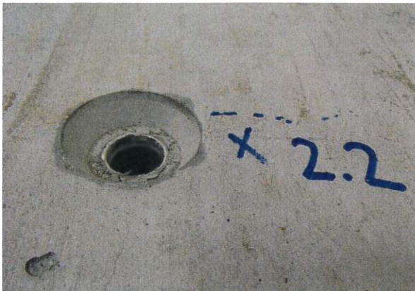
Betonhülse 2.2 nach Versuch
