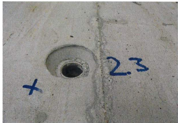
Betonhülse 2.3 nach Versuch
