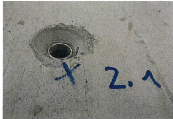
Betonhülse 2.1 nach Versuch
